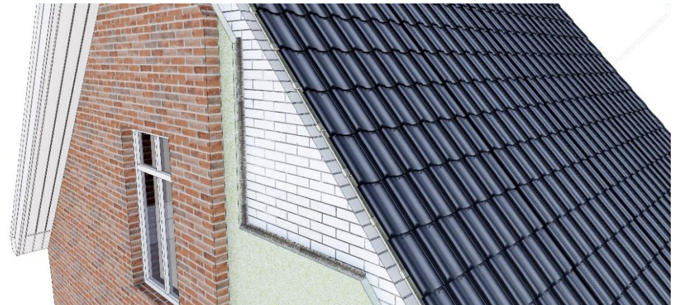
Figuur 13: Een deel van de spouw vrijlaten bij na-isolatie kan betrekkelijk makkelijk met spouwborstels. Wanneer mogelijk de bovenzijde in verbinding houden met het dakvlak.
